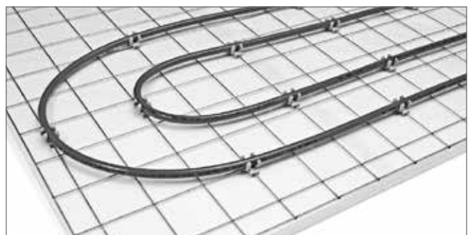
Рис. 15-20 Система крепления труб на арматурной сетке
